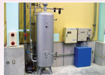
水消火加圧タンク 自動給水式
